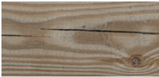
Spannungsrisse durch die Holz-trocknung
