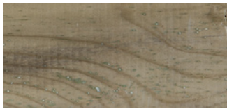
Raue Stellen auf der Holzoberfläche
