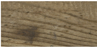
Stockflecken und leichter Schimmelbefall
